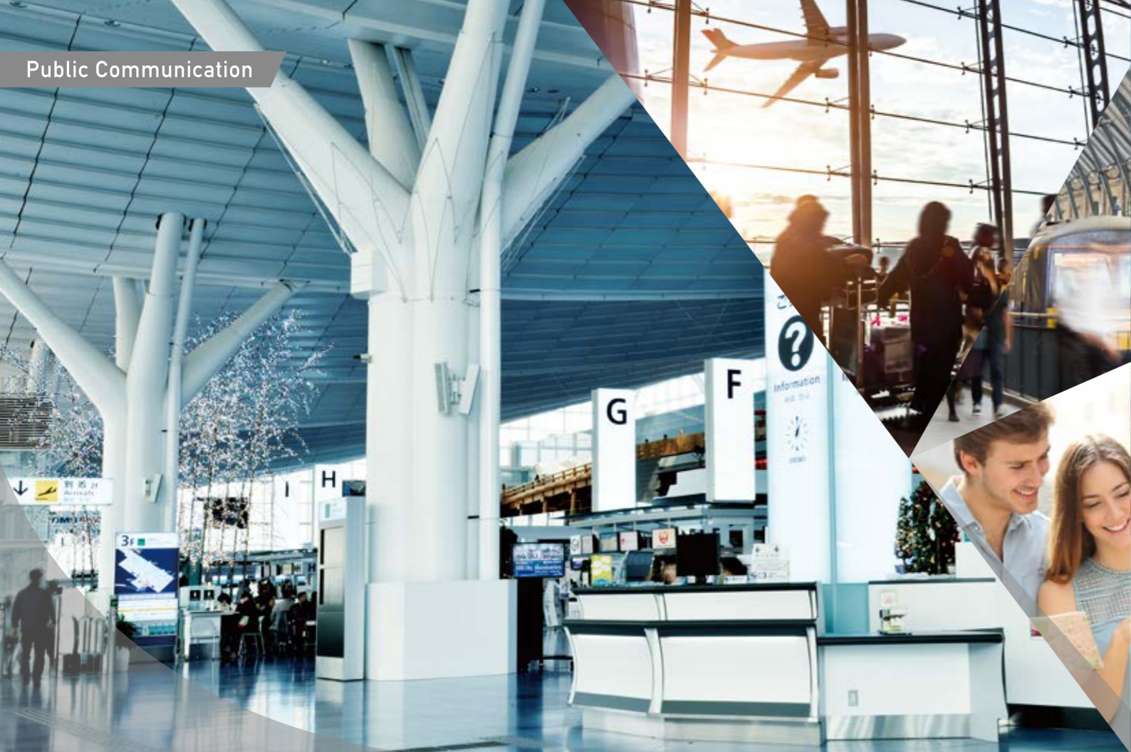
空港内旅客案内放送システム(羽田空港国際線旅客ターミナル)
